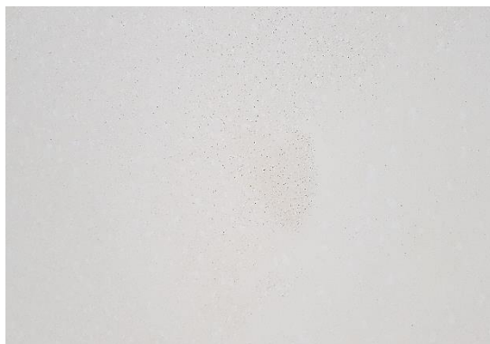
Rys. 11.1.4. Lokalne zawilgocenie wyprawy tynkarskiej
