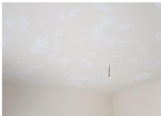
Rys. 11.1.1 Usterki tynków w poziomie stropu nad parterem – widok sufitu po wykonaniu miejscowego szpachlowania zawilgoconych miejsc tynku
