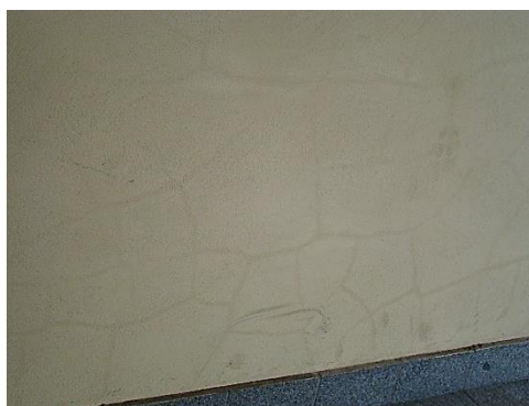
Rys. 10.4 Zarysowania wyprawy tynkarskiej ścian tunelu – typowa morfologia rys wywołanych skurczem tynku
