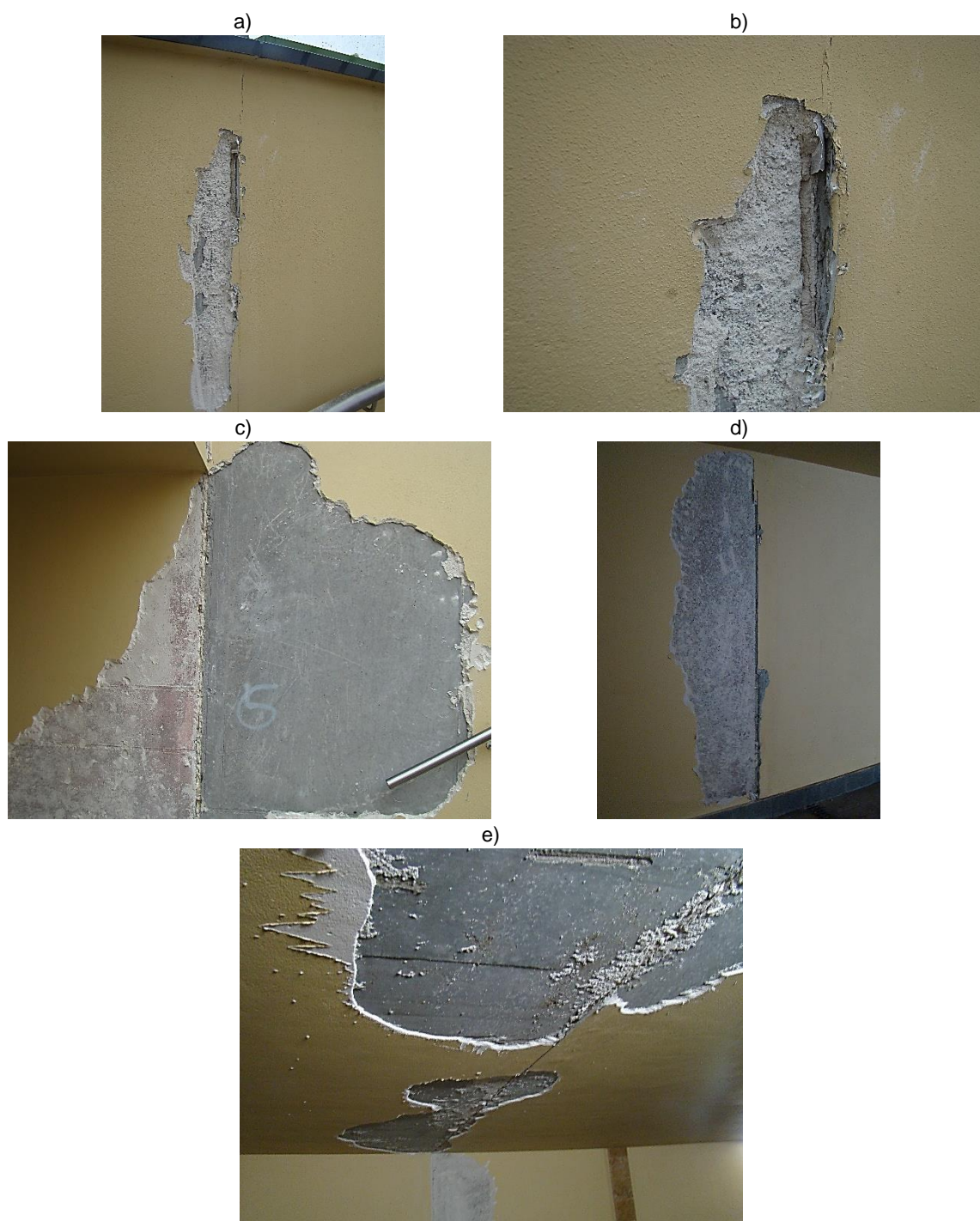
Rys. 10.2 Uszkodzenia wyprawy tynkarskiej tunelu: a), b) w miejscu dylatacji ścian obudowy wyjść z tunelu, na fragmentach c) gładkich, d) chropowatych ścian obudowy wyjść z tunelu, e) na suficie tunelu
