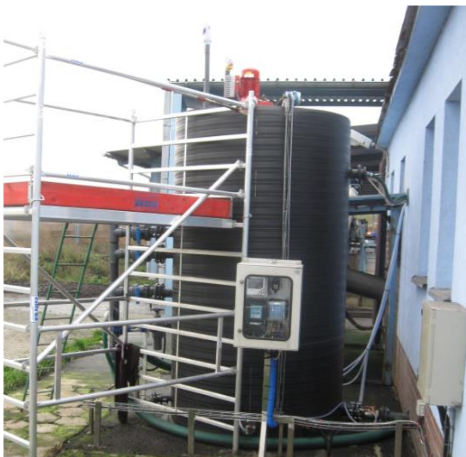
Rys. 3.4. Reaktor pilotowy SBR zlokalizowany w oczyszczalni ścieków Słupsk o pojemności 6 m 3 : (a) schemat technologiczny, (b) widok rzeczywisty
