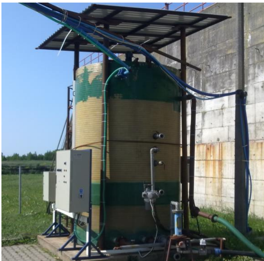
Rys. 3.3. Pilotowy reaktor SBR zlokalizowany w oczyszczalni ścieków Wschód w Gdańsku: (a) schemat układu, (b) widok rzeczywisty
